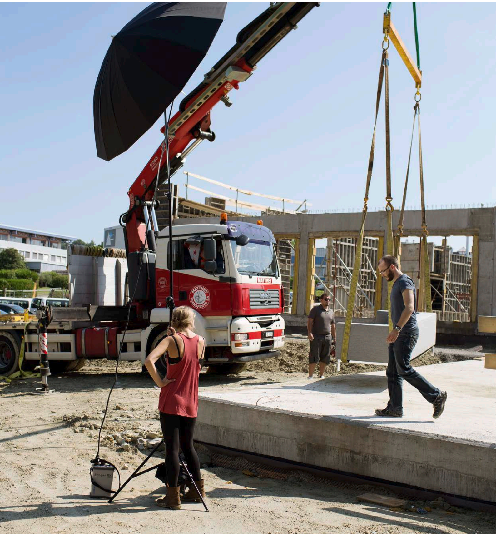
Préparation de la prise de vue de la campagne «Partenaire de vos projets immobiliers» sur le chantier des Balcons du Mont, où Retraites Populaires construit 128 logements.
